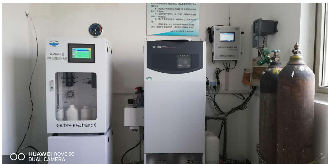
废水在线监控设施▲
