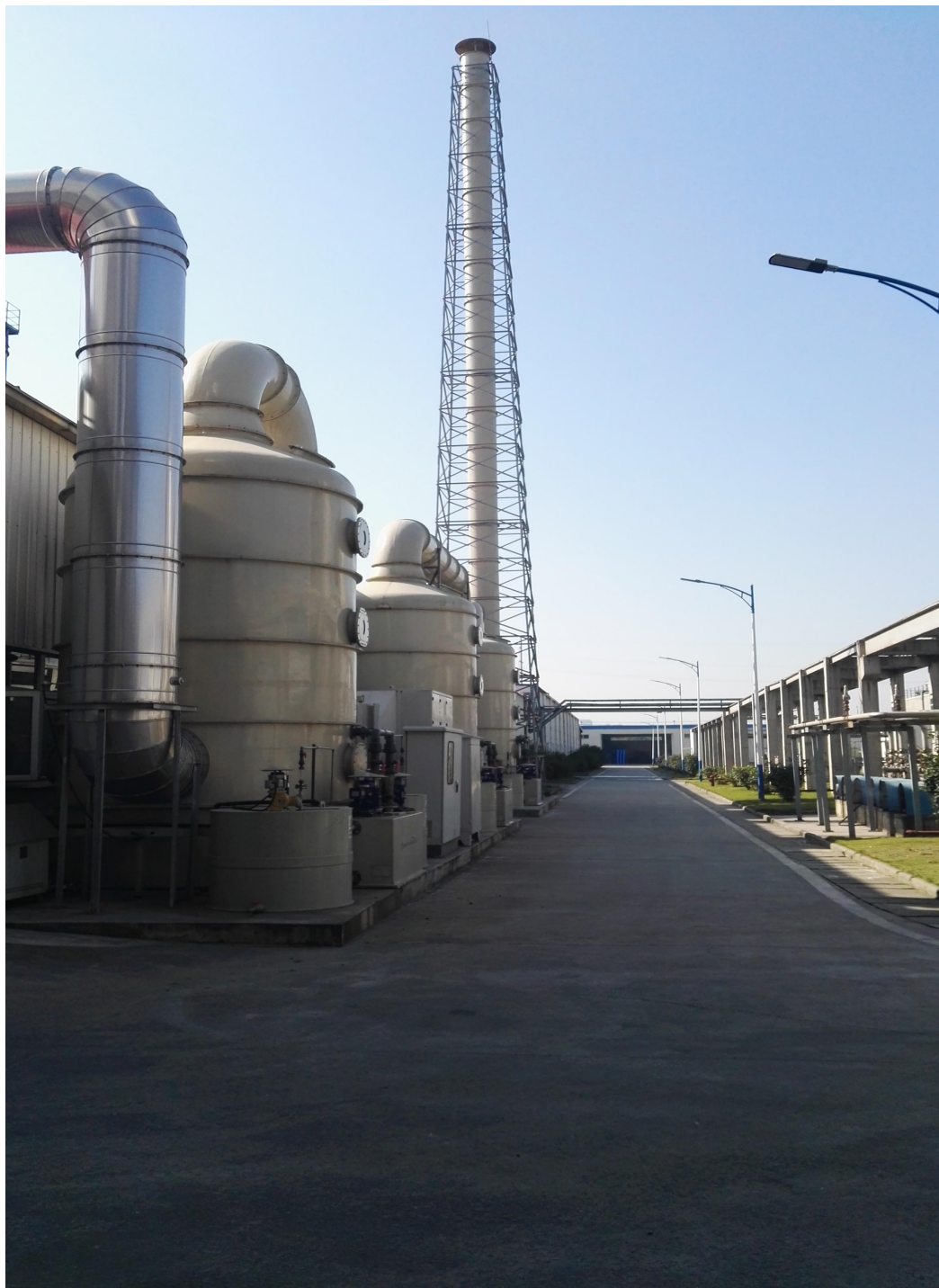
无组织废气收集治理设施▲ (CPP+碱液吸收装置)
