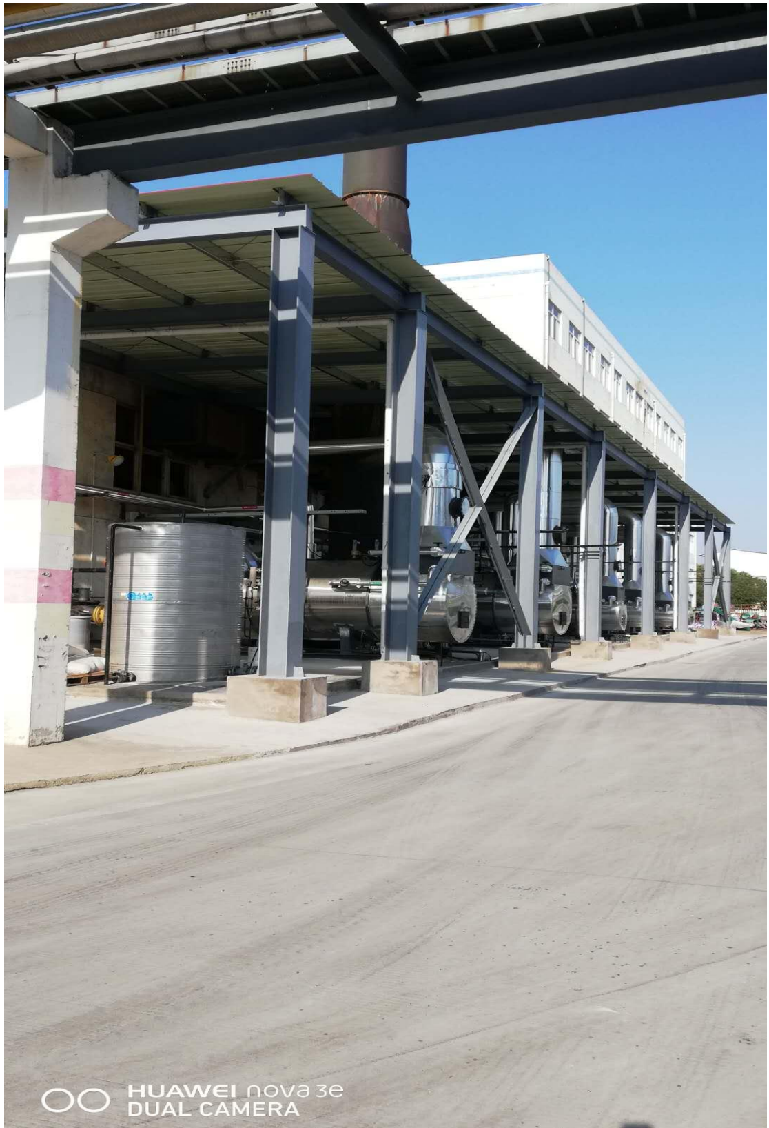
锅炉低氮燃烧机组▲
